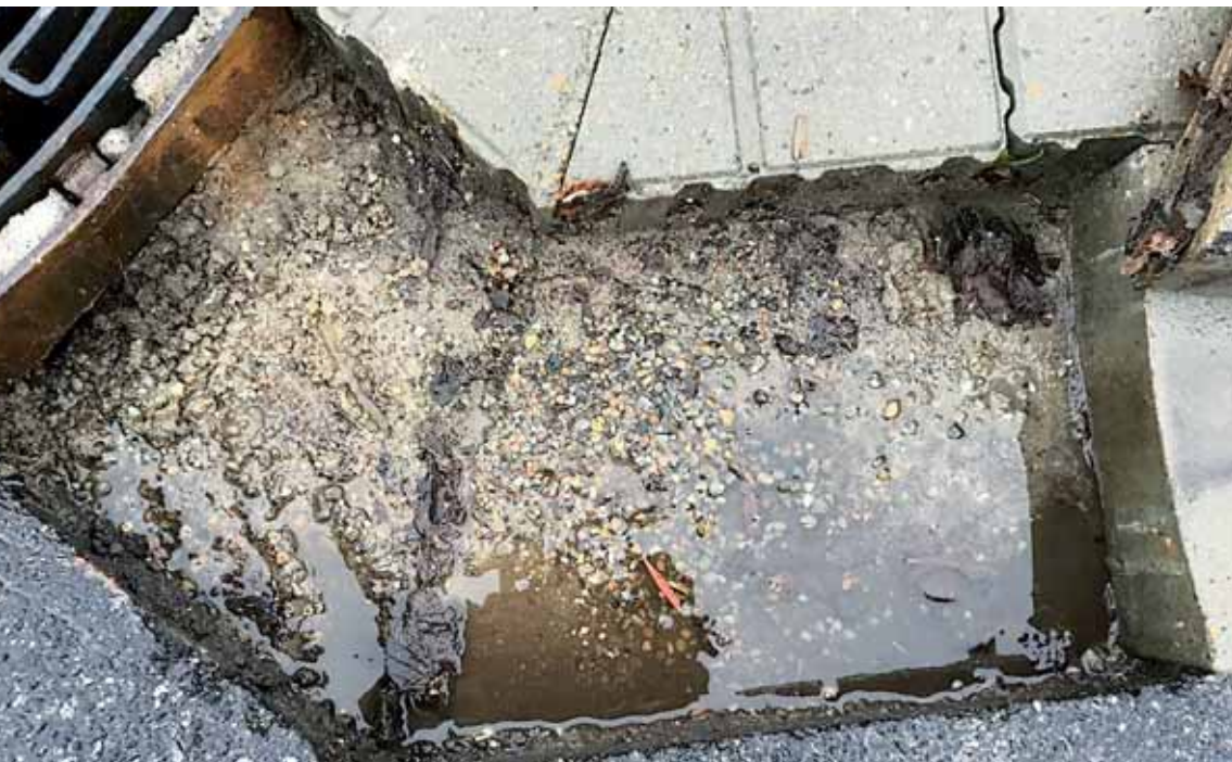
• Efter at fliserne blev taget op kom der vand ud fra den del af vandrenden der ikke var taget op.
