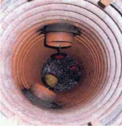
Drænrørene rager ret langt ind. Kan man komme til med at rense? Foto: Kloaktuelt, december 2022.
