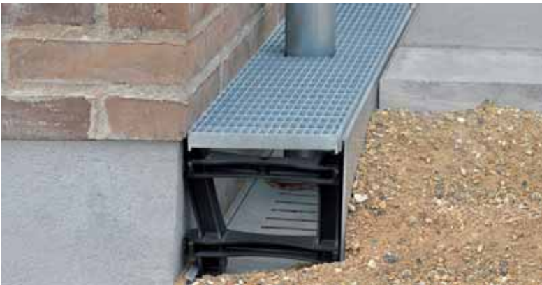
Sokkelrender er en god løsning, men skal bruges rigtigt. Foto: Milford.
