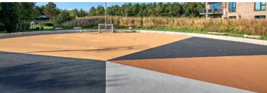
MULTIBANE. Består af 20 cm drænstab, herover 35 mm pu-bundede granitskærver og toplag af 10 mm gennemfarvet topganulat. Udført med dræn. Udført af PJ Sport ApS i Hedehusene.
