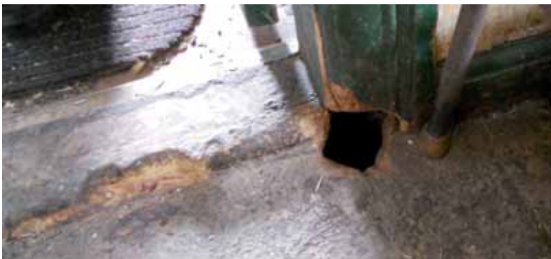
Rottehul i en dørpanel. Rottehuller er 5-7 cm store, men rotten kan mase sig gennem et hul på 2 cm hvis det er. Foto: Peter Weile.
